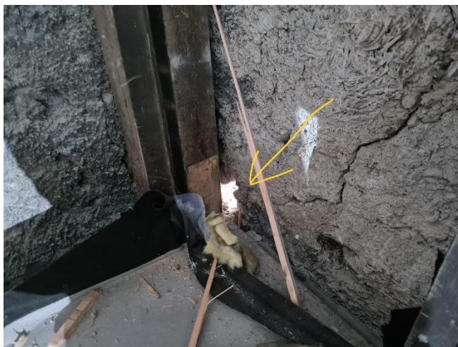
Hull gjennom opprinnelig grunnmur
